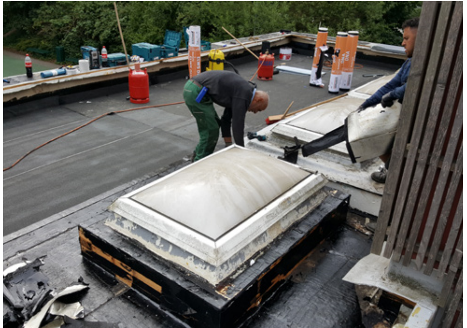
Die Reparaturarbeiten an dem Dach der „ARCHE“ in Hamburg waren dringend nötig.
