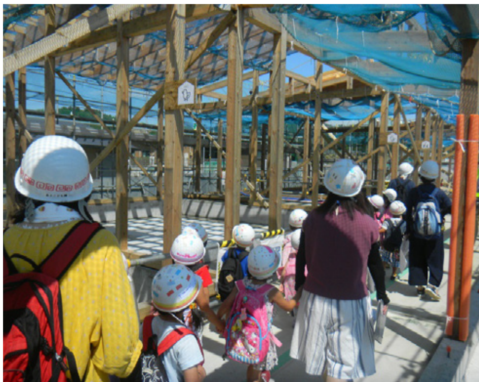
Der Neubau der Kinderkrippe in der 2011 vom Erdbeben stark getroffenen Stadt Ishinomaki schreitet gut voran.
